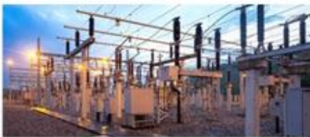
Energa Operator. Budowa stacji elektroenergetycznej RS 110kV Elbląg Północ oraz powiązań kablowych z siecią 110kV.
