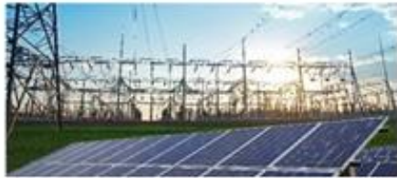
Energa Operator. Budowa RS Stężycza 110 kV w linii relacji GPZ Kościerzyna - GPZ Sierakowice dla przyłączenia PV Gapowo.
